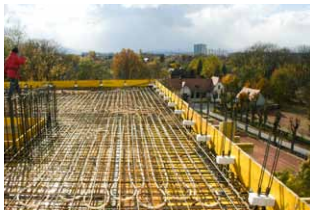
Betonkernaktivierung in den Geschoßdecken
